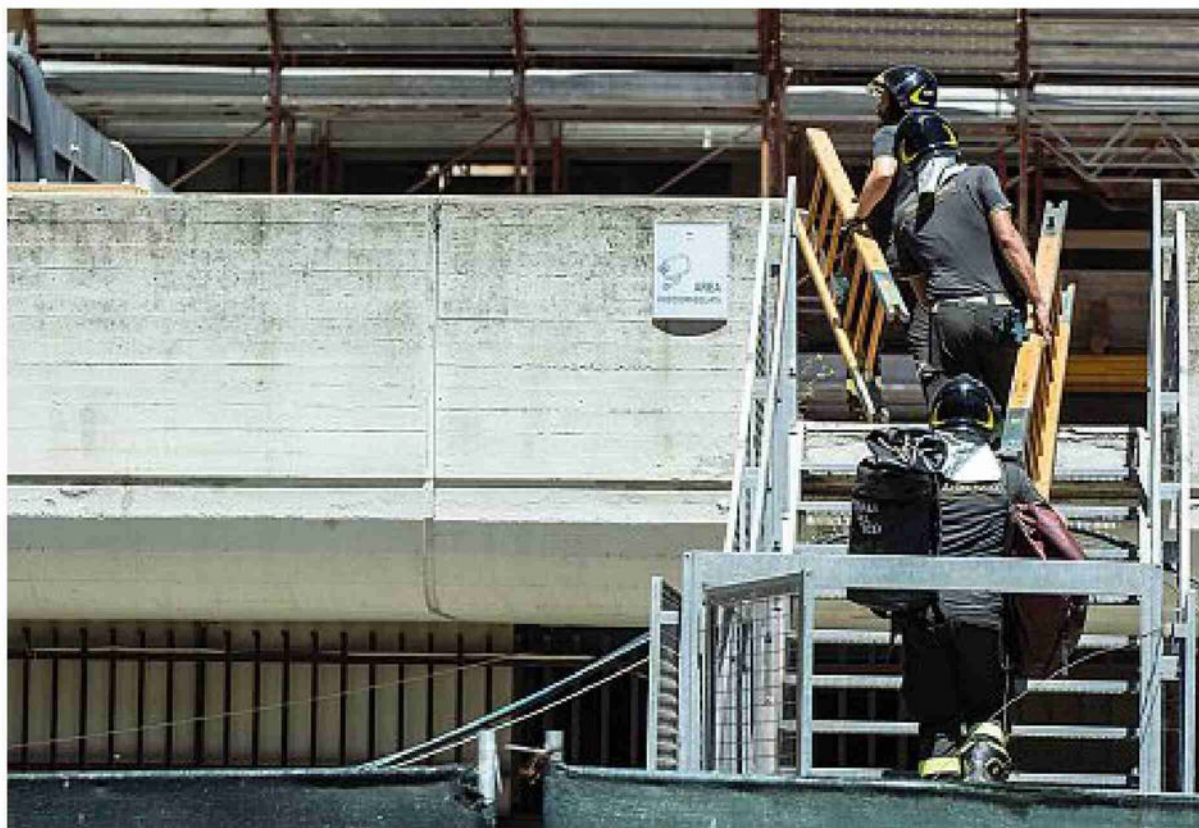
Ispezione I vigili del fuoco nel cantiere dopo l'incidente (foto Ansa/Carconi)
